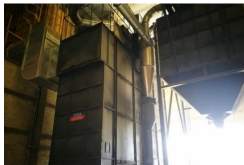
Figura 1. Horno SUNCUE SB-80 y tolva (derecha) de almacenamiento de CCA.
