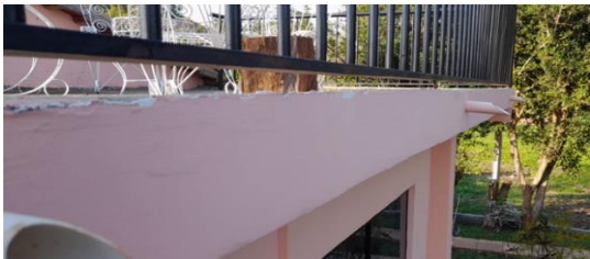
Fig. 12. Imagen de la Losa 1.
