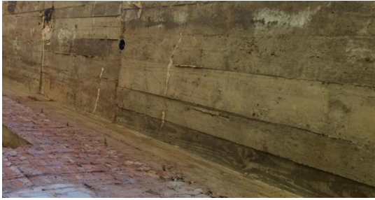
Fig. 15. Imagen de la Losa 6.
