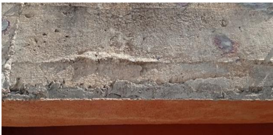
Fig. 13. Imagen de la Losa 2.
